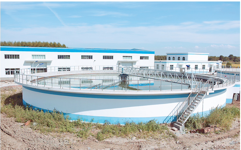
成高子镇污水处理厂二沉池。
