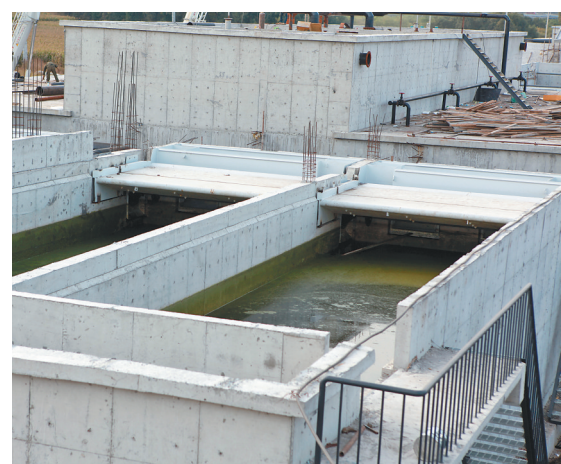
朝阳水质净化厂悬浮澄清池。
