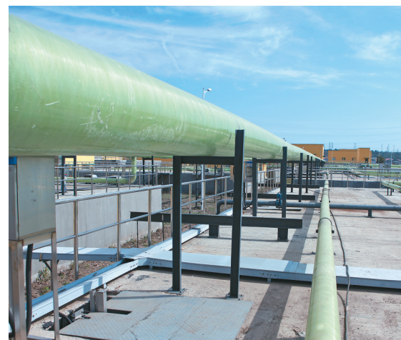
团结镇污水处理厂除臭管道。
