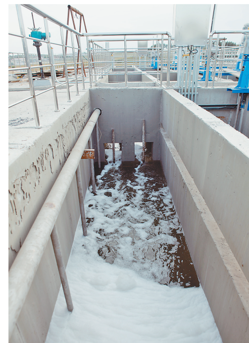
朝阳水质净化厂S4D池。
