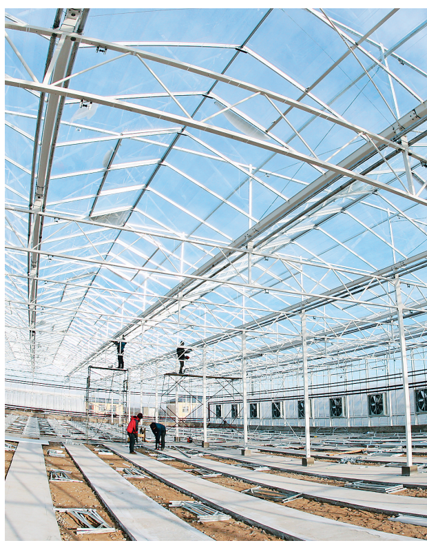
近日,在兰西县榆林镇高标准蔬菜种植园区,工人们正忙着建设智能温室。智能温室是采用物联网、传感技术等高科技,对生产全过程进行智能化控制与操作,实现蔬菜种植的标准化生产。据了解,园区投用后,将有助于转变农业发展方式、调整种植结构,加快向现代农业转型。 计翰 本报记者 苏强摄
