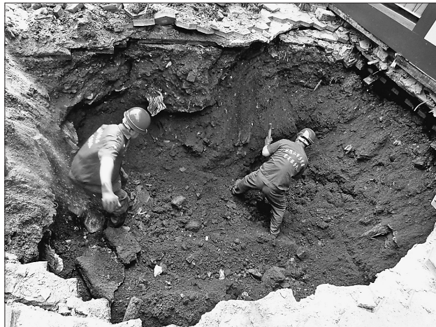
7月11日,尖山区西平路七马路食品公司住宅楼发生塌陷,市房产管理局党员服务队赶到现场进行维修。 张龙摄
