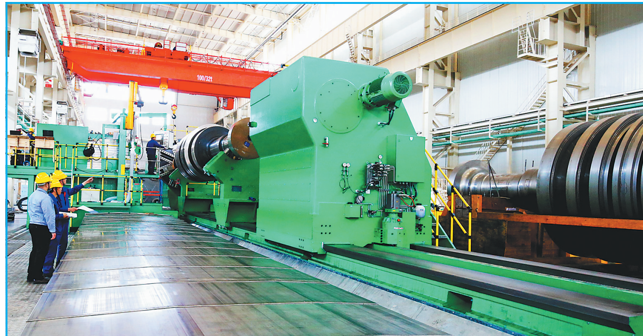
哈尔滨汽轮机厂有限责任公司投资86775万元建设的核电重型厂房，配备了先进的生产设备，成为国际一流的大型、清洁、高效的汽轮机生产厂房。由汽轮机公司完全自主研发的VVER-1000核电常规岛田湾核电二期工程3号机组就在这诞生。
