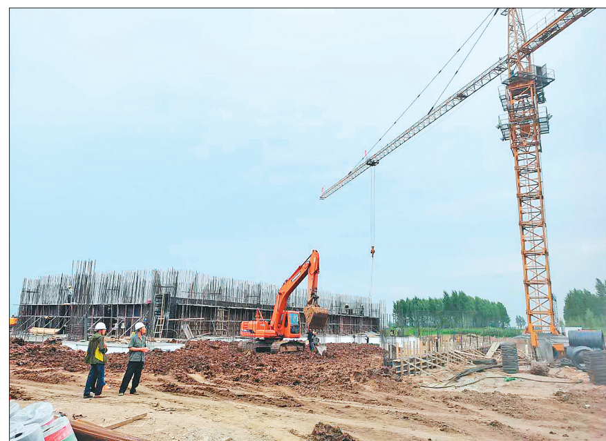
通河县水发龙能资源再生利用有限公司二期工程建设现场。本报记者 王志强摄
