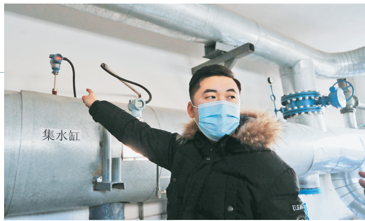
换热站工作人员查看回水温度。
