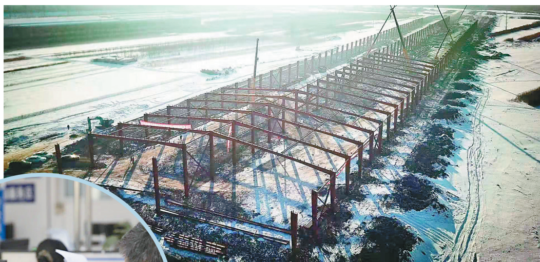
正威哈尔滨新一代材料技术产业园一期建设现场。本报记者 曲静 薛婧摄
