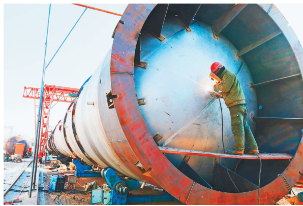
在华瑞生物项目现场,工人正在焊接发酵罐。 闫艺丹 本报记者 姚建平 摄
