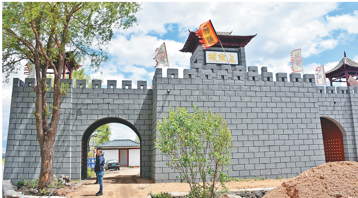
渤海唐风小镇景观区项目是第四届旅发大会重点观摩项目,其中的仿上京城项目主要以“海东盛国”为主线,对原上京城内景点建筑进行维修、改造和翻建。既展现唐代渤海国时期的建筑风貌,同时利用建筑进行地方特色产品的展览和交易,打造具有唐代渤海国风格的商业区、客栈、护城河和渤海文化展示区。目前,已完成河道清理、园林布置,正在进行仿唐商铺内部装修,项目将于6月30日完工。 付文军 黑龙江日报全媒体记者 刘晓明摄
