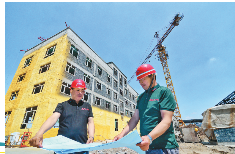
黑龙江省南益粮康科技发展有限公司微生物培养基研发生产基地项目将于7月竣工投产。黑龙江日报全媒体记者 韩波 邢汉夫
