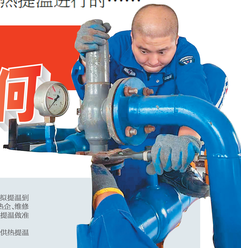
技术人员正在调试换热站。
