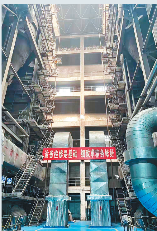
华能供热的热源车间。
