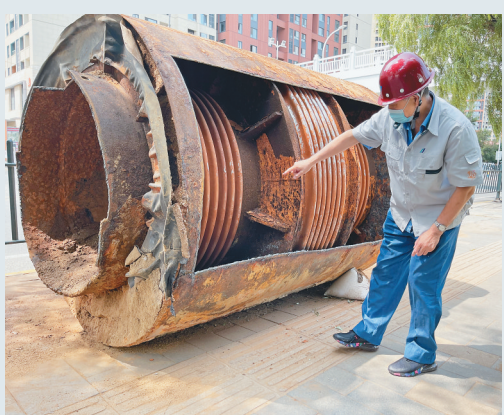
民生路供热管线更换下来的补偿器。
