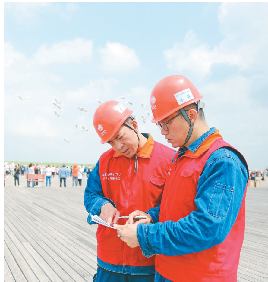
国网黑龙江电力(齐齐哈尔)共产党员服务队队员来到扎龙国家级自然保护区对景区内内部变压器、设备配电房、低压线路进行仔细检查,为区域旅游快速发展提供坚强电力保障。
