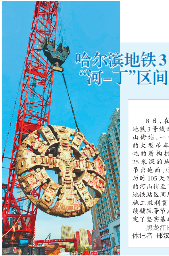
8日，在哈尔滨地铁3号线西北环河山街站，一台450吨的大型吊车将50余吨的盾构机刀盘从25米深的地下缓缓吊出地面，标志着历时105天连续奋战的河山街至丁香公园地铁站区间盾构掘进施工胜利贯通，为后续铺轨等节点目标奠定了坚实基础。
