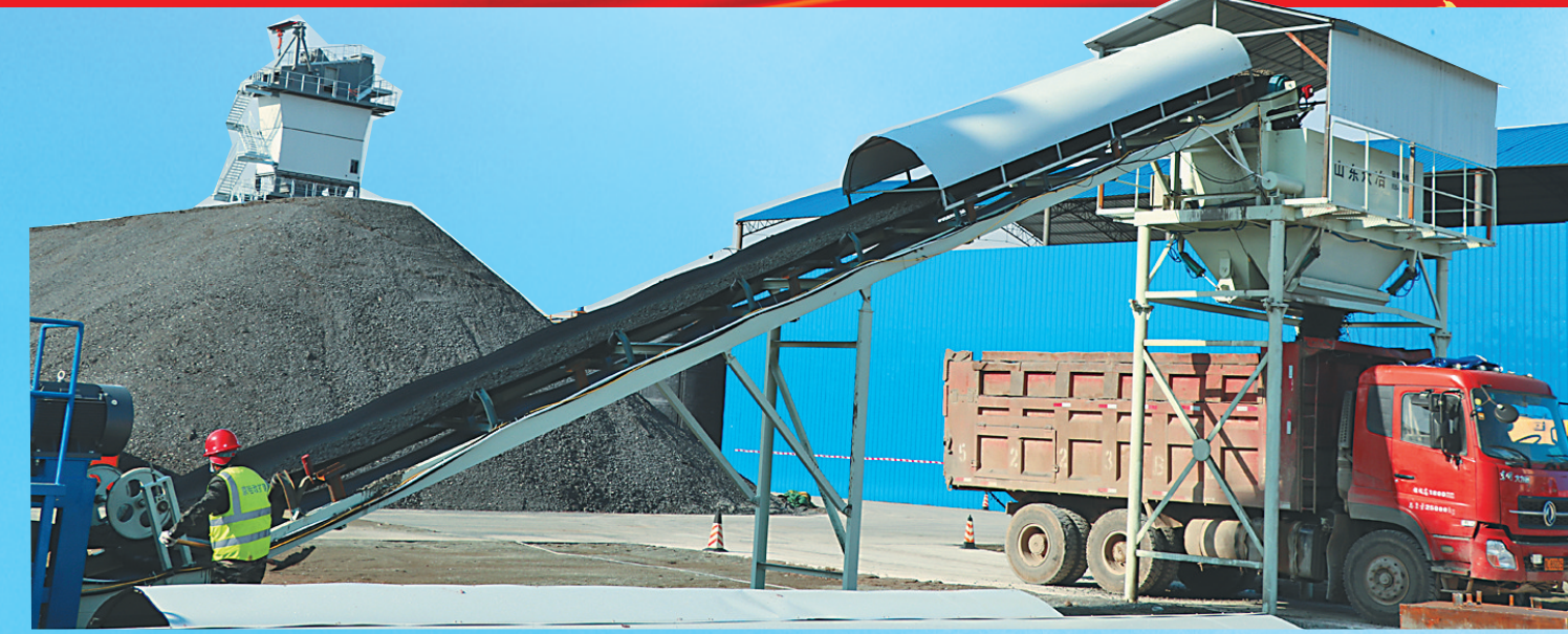
基层混合料拌合站。
