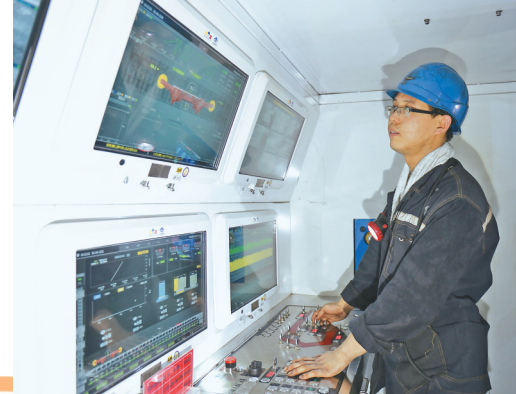
智能化采煤井下集控平台。
