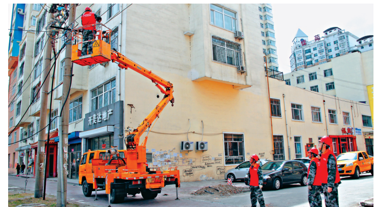
日前,供电公司共产党员服务队队员在架设低压电缆。佳木斯供电公司通过对陈旧变压器设备增容改造、新增布点及负荷割接等措施,有效解决低电压问题,满足辖区电力客户用电需求,助力地方经济发展。何佳摄
