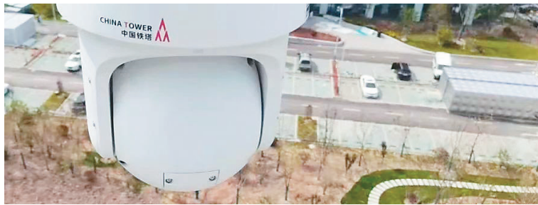
悬挂在铁塔上的高清摄像头。
