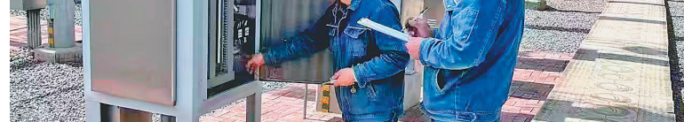
伊春供电公司积极完善保电各项措施,近日,运维站值班员对220kV伊春变电站进行特殊巡视和红外测温。
