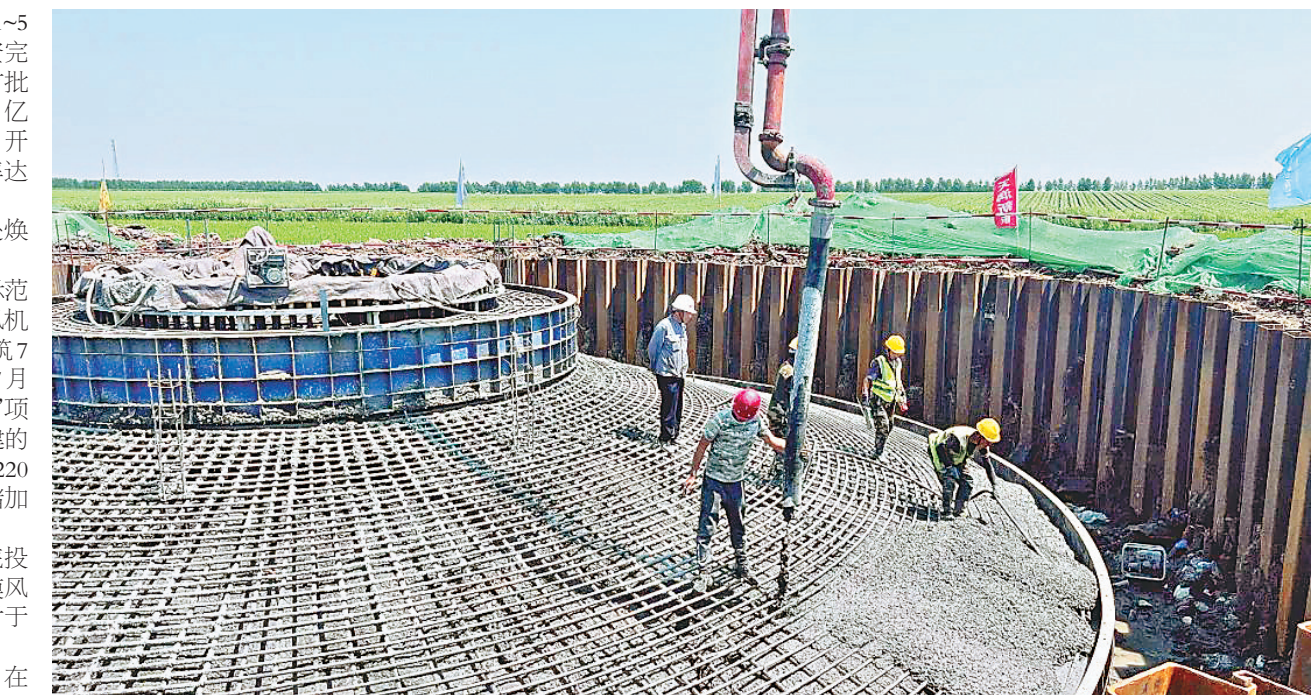
勃利县20万千瓦风电制氢联合运行示范项目建设现场。 杨崴摄
