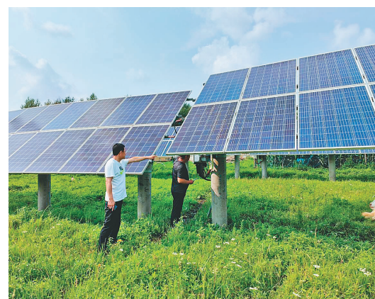
光伏日常维护。
