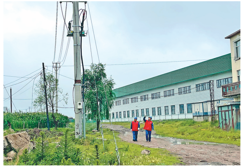
8月,国网明水县供电公司组织开展线路防汛保障特巡工作,对辖区内防汛重点线路进行巡视检查,确保电网安全度汛。 李美玲摄
