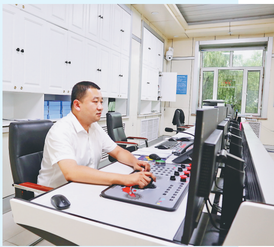
采掘工作面地面一键启动。 图片由龙煤双矿提供
