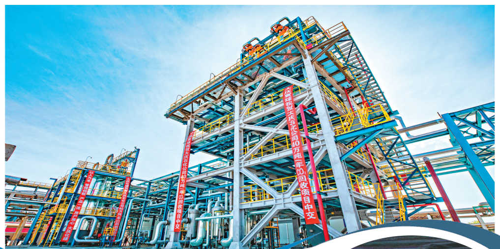
↑大庆石化40万吨每年高浓度二氧化碳回收项目。
