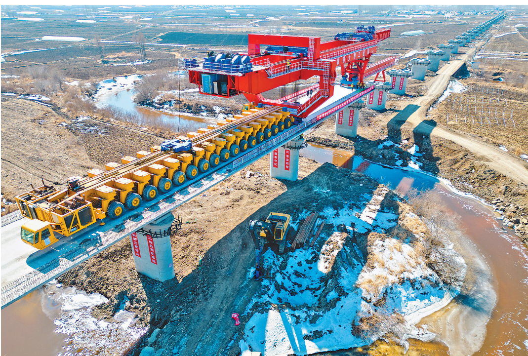
在哈伊高铁安邦河特大桥施工作业点,中国铁建大桥工程局集团有限公司的工作人员在进行架梁作业(无人机照片)。
