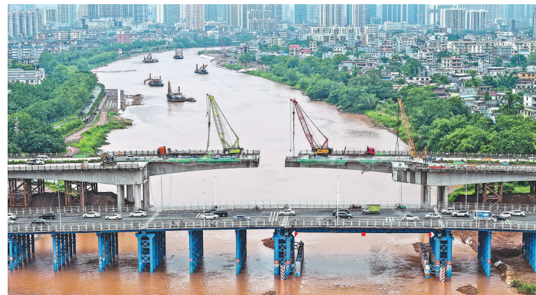
5月26日,在钦州市钦江江面上,施工队在拆除钦江三桥。近日,广西平陆运河建设施工队伍抢在汛期来临前,开展拆除钦江面老桥、疏浚河道等工作。
