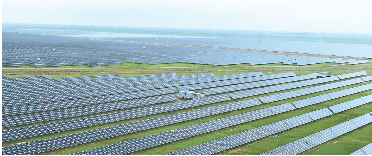
一、二期项目建成的光伏“海洋”。
