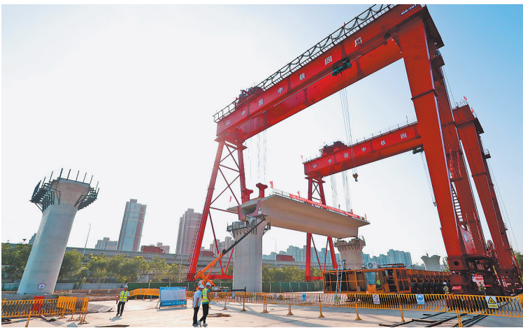
26日,由中铁四局承建的沪渝蓉高铁上海段首根箱梁架设完成,标志着该段正式进入桥梁架设阶段。图为施工现场。 新华社发
