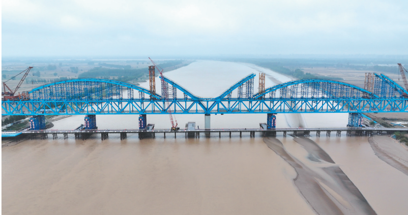
10月18日拍摄的雄商高铁黄河特大桥主桥施工现场。当日,由中铁四局集团承建的雄(安)商(丘)高铁跨黄河特大桥主桥首个拱肋顺利合龙。雄商高铁黄河特大桥主桥在河南省台前县和山东省梁山间跨越黄河,主桥总长1600米。雄商高铁是国家“八纵八横”高铁网的重要组成部分,北起河北雄安新区、南至河南商丘站,线路全长约552公里,设计时速350公里。新华社记者 朱祥峰
