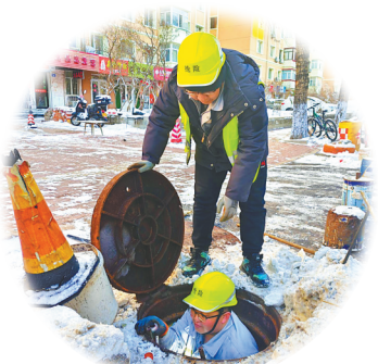
金山堡供热公司工作人员下井检查供热设备。
