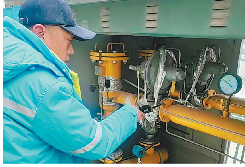
工作人员检查调压柜。
