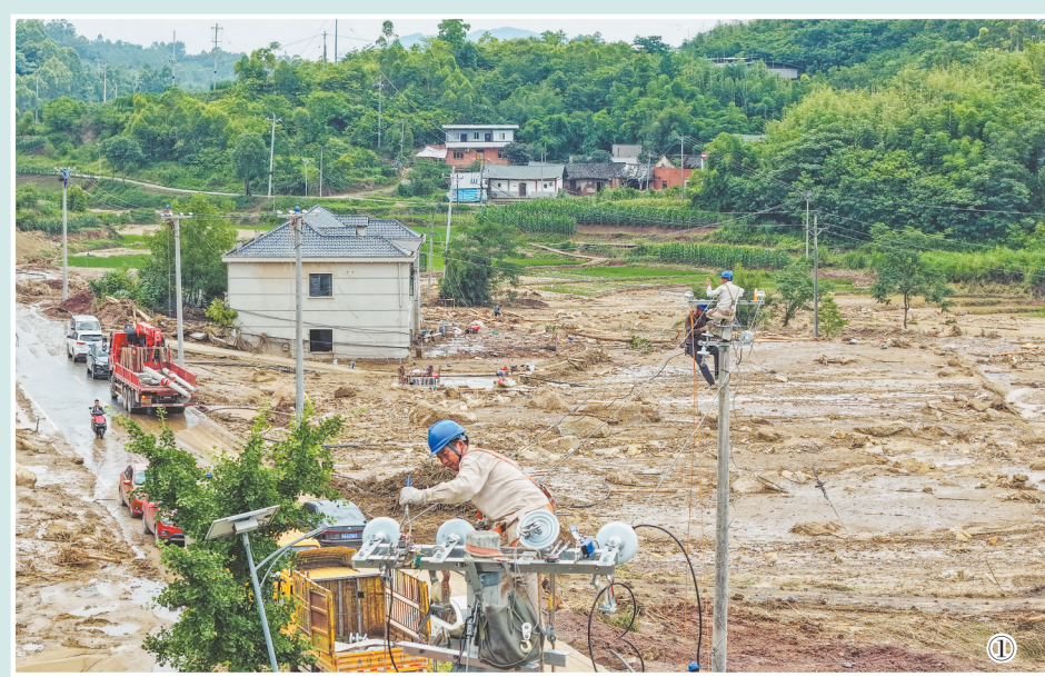
图①:5月26日,在重庆市永川区茶山竹海街道安溪村,国网重庆永川供电公司工作人员抢修供电线路(无人机照片)。
