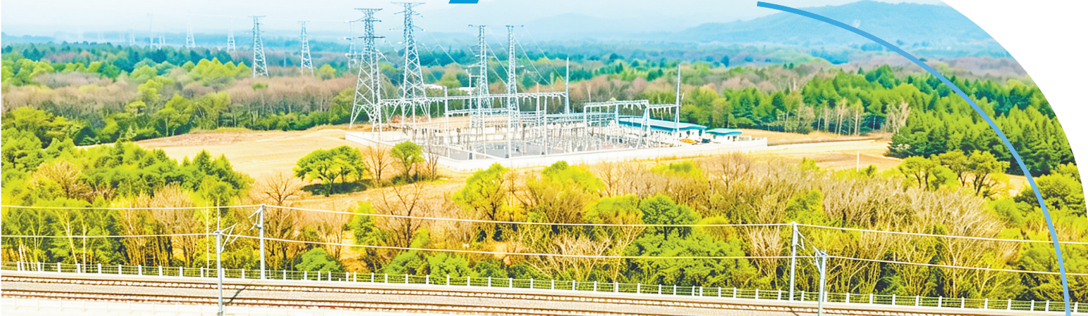
图①:铁伊电铁新曙光牵引站220千伏外部供电工程与高铁轨道同程。 图②:在220千伏东安甲乙线检修现场,国网绥化供电公司组织作业人员开展高空绝缘子串吊装作业。
