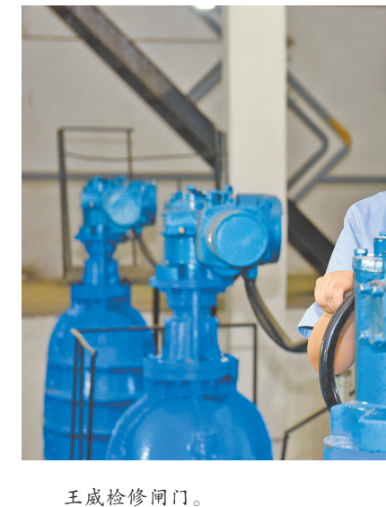
王威检修闸门。
