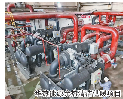
华热能源余热清洁供暖项目
