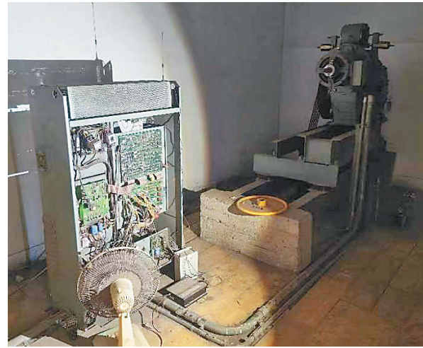
经过整改 电梯目前运行良好
