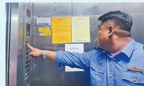
找到电梯故障原因
