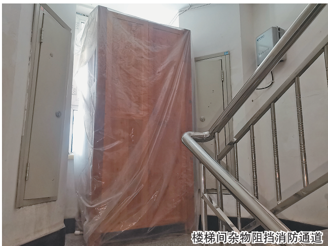
楼梯间杂物阻挡消防通道
