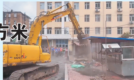
介绍,新学街是主干街路新阳路的辅街,周边两侧房屋均是20世纪建成的老旧房屋,部分居民依附围墙搭建了简易棚、砖混结构的建筑物存放物品,还有人用栅栏圈地种菜,不仅侵占人行道,还存在安全隐患,执法人员对该处违建进行了依法拆除。
