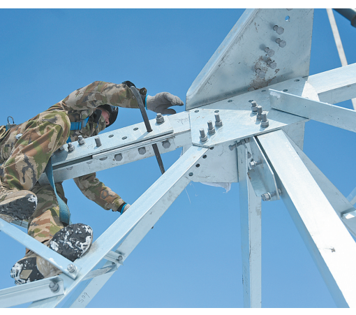
绥化500千伏新能源汇集输电工程是服务哈大齐绥新能源产业带发展的重点项目,工程建成后,可满足绥化市及周边区域内约200万千瓦风电、光伏新能源项目集中汇集接入需求。图片由国网黑龙江电力提供
