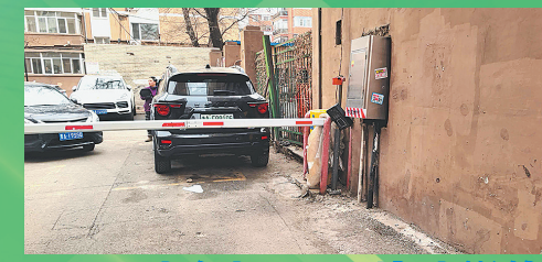
挡车杆失灵 快速维修
