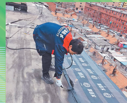
防水层破损 马上修缮
